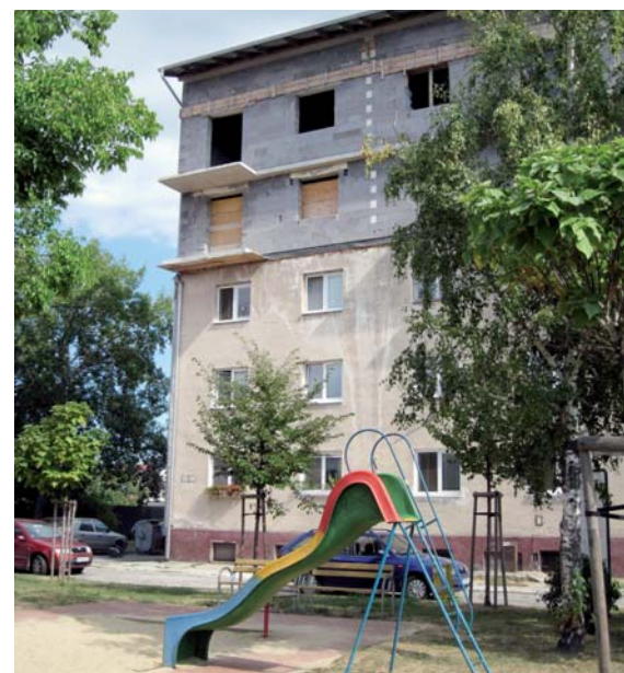
Nadstavba na Pluhovej spôsobuje majiteľom pôvodných bytov značné problémy
