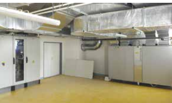
Technická miestnosť s jednotkou vzduchotechniky a technológiou fotovoltaikej elektrárne
